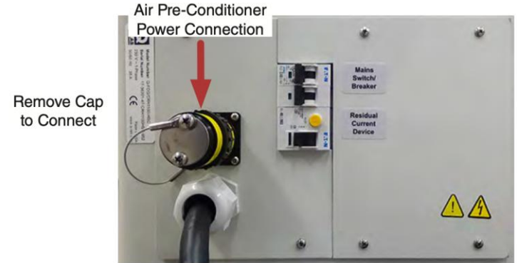
Power Outlet จากเครื่อง Q-FOG จ่ายไฟฟ้าให้กับ Chiller
