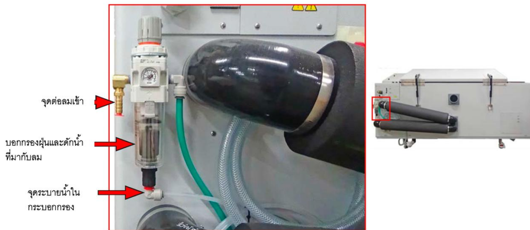
Air Regulator ดักน้ำที่มากับลมก่อนจ่ายเข้าเครื่อง
